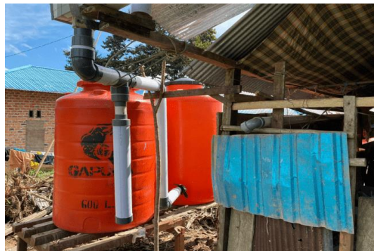
Gambar 5. Sistem pemanenan air hujan berfilter telah terpasang
