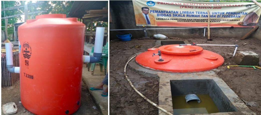
Gambar 2. Tabung Digester Dan Instalasi Biogas.
