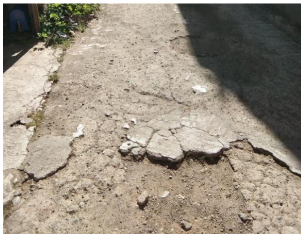
Gambar 1. Kondisi jalan di Kampung Sugutamu
