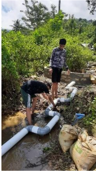
Gambar 4. Proses perbaikan kebocoran alat
