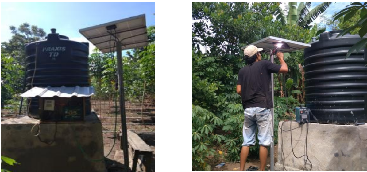
Gambar 3. instalasi panel surya, sumur bor, irigasi tetes dan penampung air
