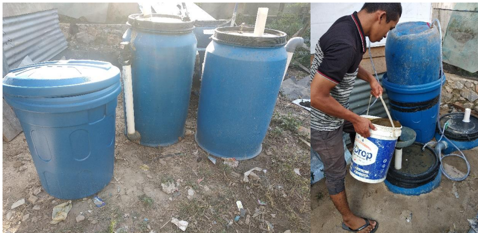
Gambar 2. Kelengkapan Instalasi Biogas Mini.
