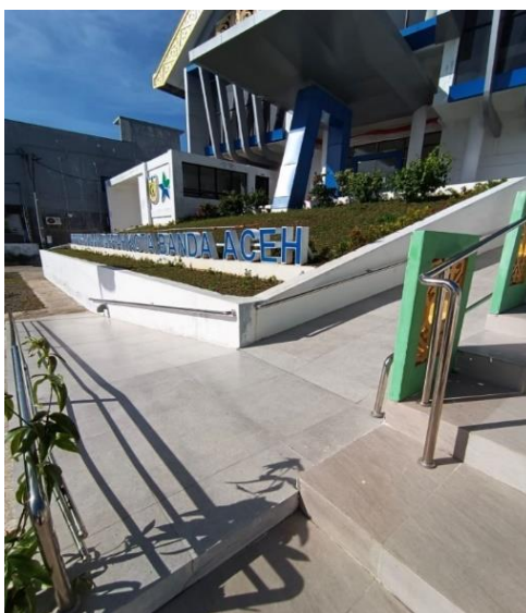
Gambar 3. Bentuk fisik ramp menaiki gedung perpustakaan yang terlalu curam
