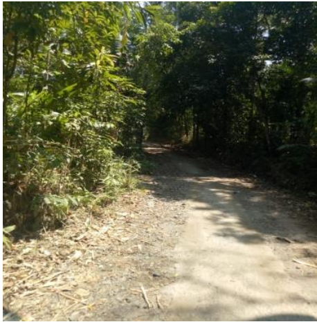
Gambar 3. Kondisi Jalan Desa Kekait
