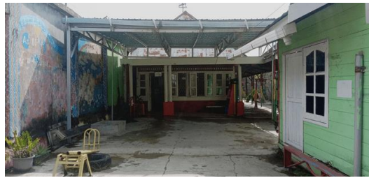
Gambar 1. Kondisi TK Ar Raudah Banjarmasin
