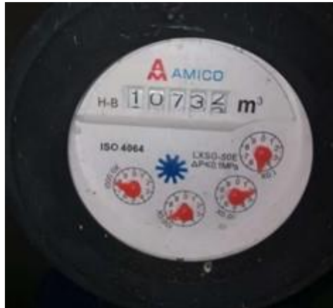
Gambar 6. Flow meter yang digunakan untuk mengukur air limbah olahan STP
