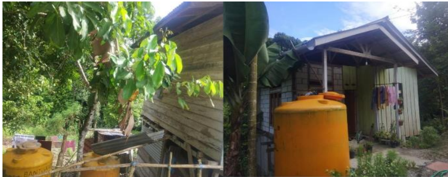
Gambar 1. Kondisi Instalasi Air Hujan Warga yang Terpasang Seadanya
