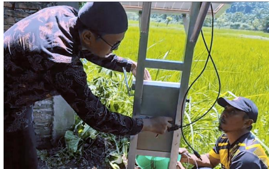
Gambar 2. Instalasi sistem AWS dan boks kontrol di lahan pertanian mitra.
