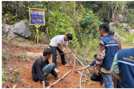
Gambar 2. Pemasangan Papan Informasi dan QR Code
