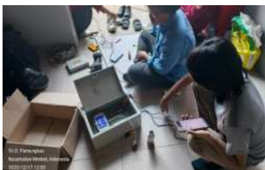
Gambar 3. Intervensi teknologi pada mitra kelompok tani, Instalasi sistem solar cell-kontrol otomatis
