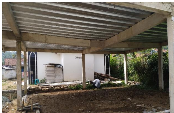
Gambar 2. Kondisi Gedung Yang Mengalami Lendutan Pada Struktur Bangunan
