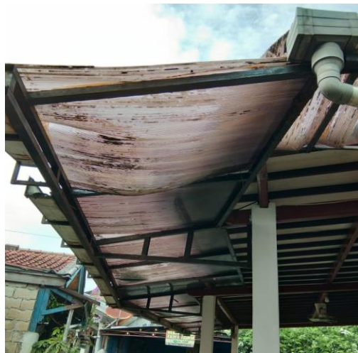
Gambar 2. Kondisi atap musholla Al-Amin yang hampir roboh
