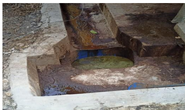
Gambar 12. Penyumbatan pada penampungan kotoran sapi
