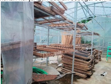
Gambar 2. Kondisi Dome Sebelum Perbaikan (Sumber : Dokumen Pribadi)
