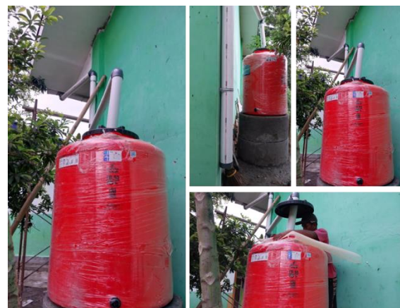
Gambar 7. Dokumentasi Instalasi Pemanenan Air Hujan yang Dipasang di SDN Lanteng Baru
