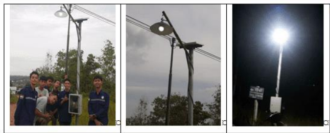
Gambar 1. Lampu penerangan jalan yang terpasang di RT 67 Kelurahan Sepinggán
