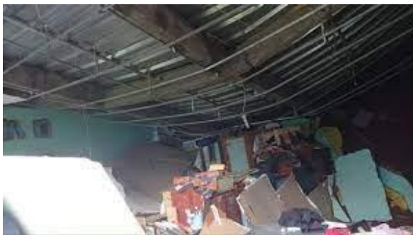
Gambar 1. Reruntuhan Bangunan Asrama Putra Akibat Longsor
