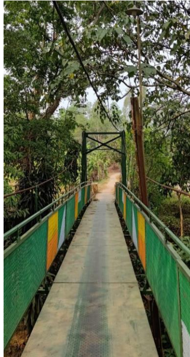
Gambar 3. Kondisi eksisting jembatan Gintung, Cilejet, Parung Panjang
