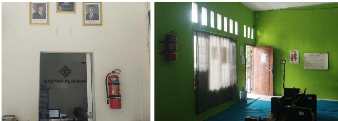
Gambar 10. Peletakan Alat Safety Kebakaran (APAR) di Bangunan Gedung Pesantren (Kantor Pesantren, Laboratorium Komputer, dan Dapur)
