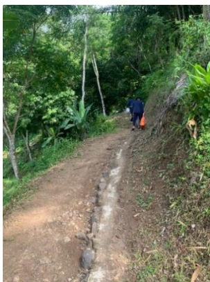
Gambar 1. Jalan setapak dengan perkerasan beton yang sudah rusak.
