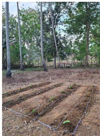
Gambar 6. Kondisi lahan pekarangan warga Desa Rakadua setelah pemasangan sistem penyiraman otomatis
